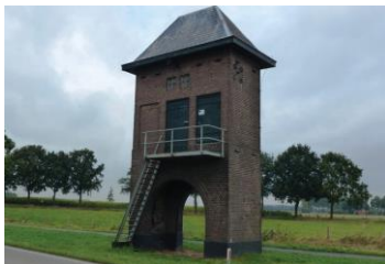
Transformatorkast Persingen. Foto: Havang (nl) via Wikimedia Commons.
